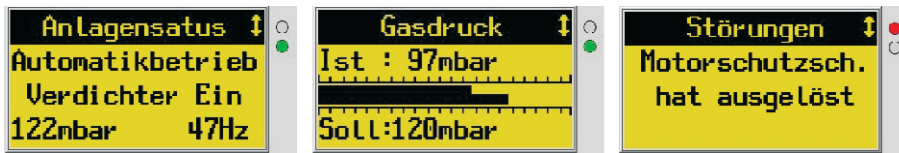
Bild 7: Statusanzeige der Steuerung
